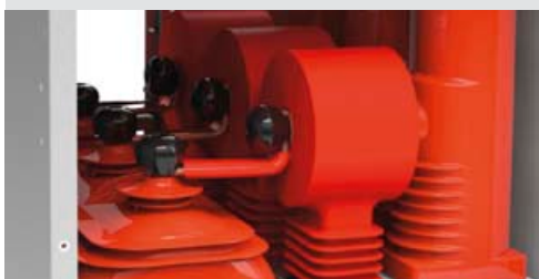
Трансформатор тока в КСО 20 кВ
