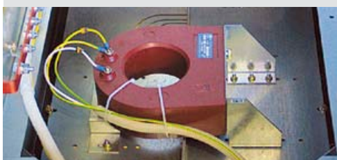
Трансформатор тока нулевой последовательности
