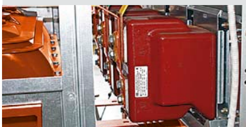
Трансформаторы тока в КСО 10 кВ
