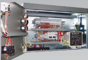
Отсек релейной защиты
