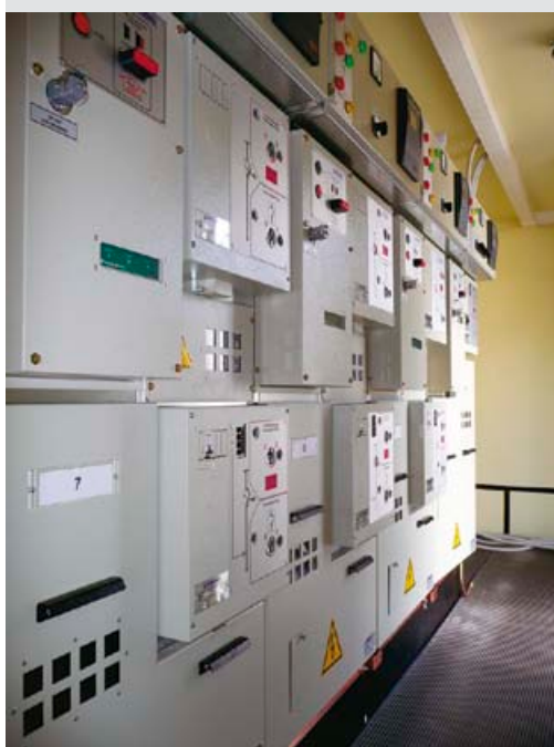
Распределительное устройство на базе ячеек КСО «Онега» в БКРПБ
