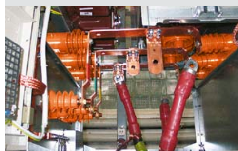
Фронтальное подключение силового кабеля
